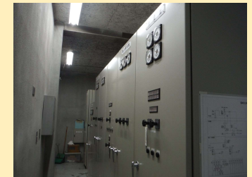
高圧受配電設備【33年経過】 (メーカー耐用年数20年)
