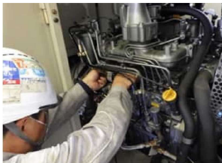
自家発設備保守・点検
