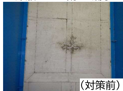
床版のひび割れ・漏水
