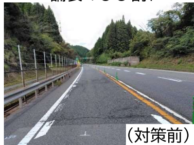
舗装のひび割れ
