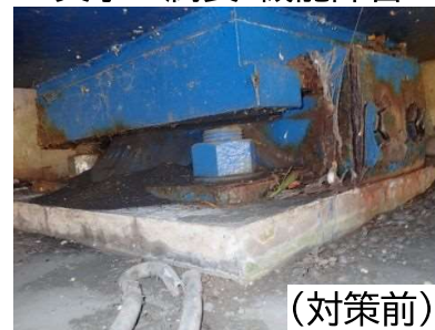
支承の腐食・機能障害
