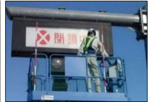
ETC車線表示板点検
