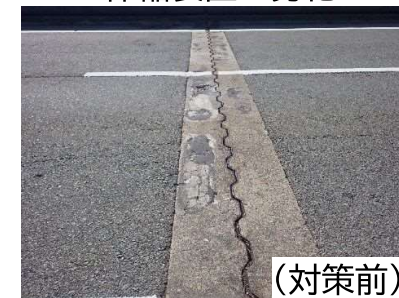
伸縮装置の劣化
