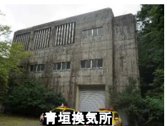
【耐震性能不足】
