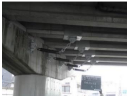
【対策事例：落橋防止装置】
