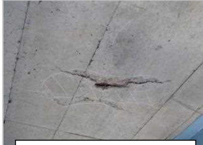
床版のコンクリートの剥離
