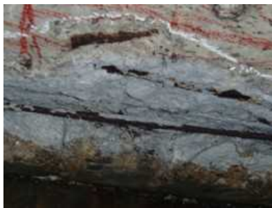
長昌寺橋 1974年架設 判定区分Ⅲ
