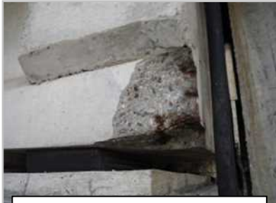
主桁のコンクリートの剥離
